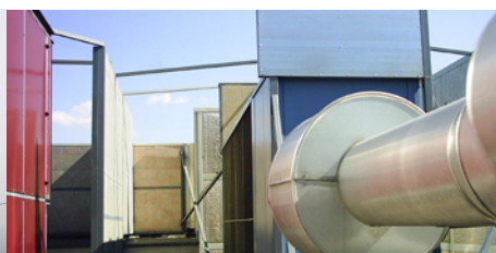
BHG – tetőtéri klímaberendezések zajárnyékolása
